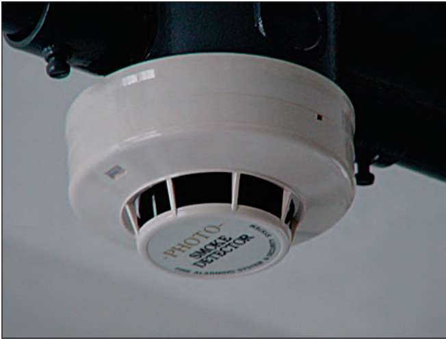
Figura 57: Detector de incêndio
