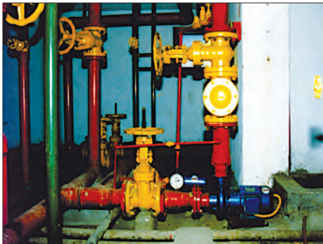
Figura 66: Bomba de incêndio e acessórios hidráulicos
