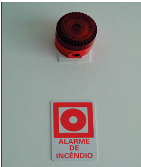
Figura 59: Detalhe de sirene
