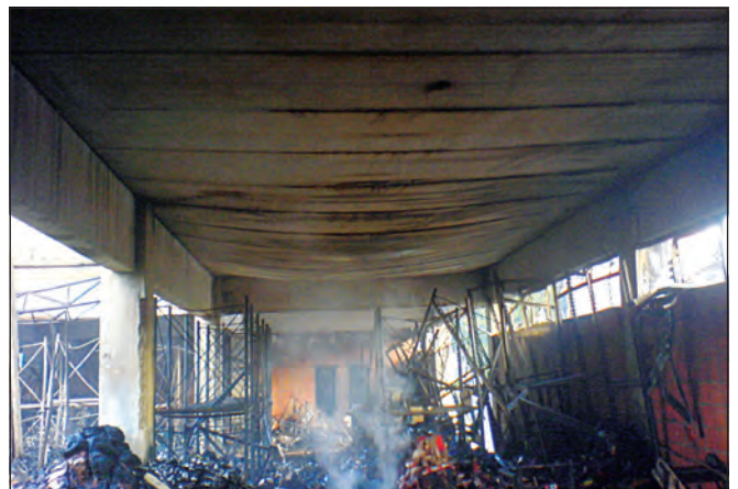
Figura 15: Incêndio no pavimento
