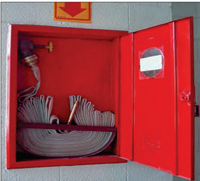
Figura 4: Sistema de hidrantes
