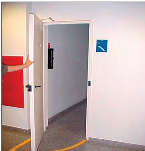
Figura 52: PCF em corredor
