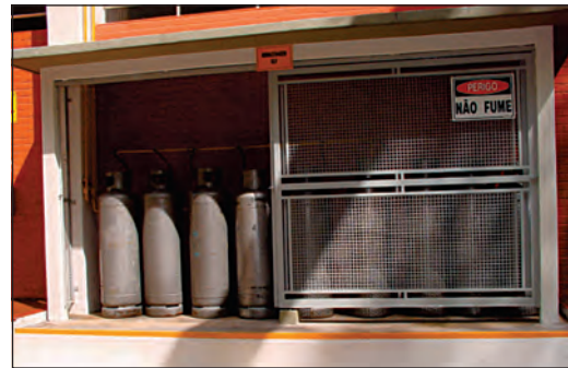
Figura 77: Bateria de GLP
