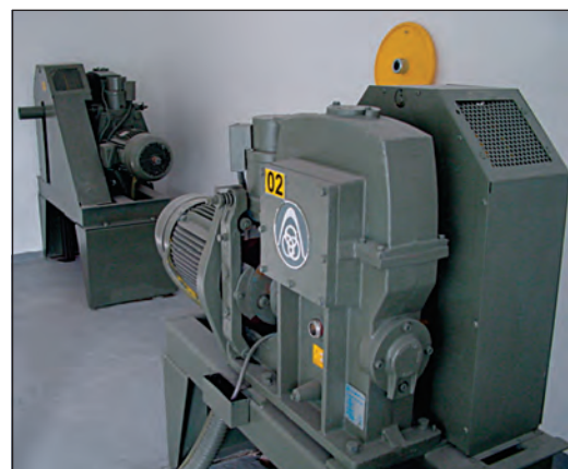
Figura 79: Casa de máquinas dos elevadores
