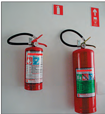
Figura 9: Extintor de incêndio
