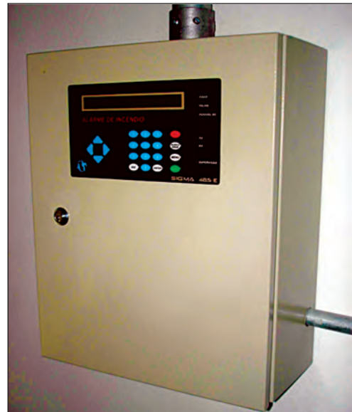
Figura 60: Central de alarme
